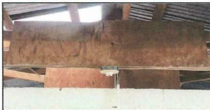
Foto 4: soporte de bigas quebrada y apolillada del aula de preparatoria A
