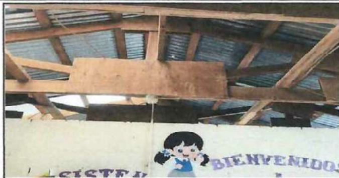
Foto 2: Armadura de vigas del aula de preparatoria B en su totalidad apolilladas.
