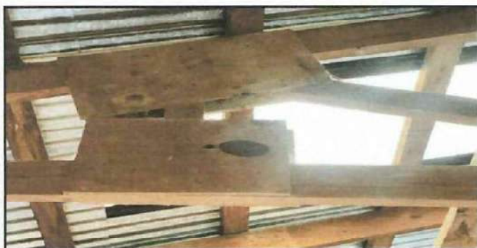
Foto 3: soportes de vigas de madera quebradas del aula de preparatoria B
